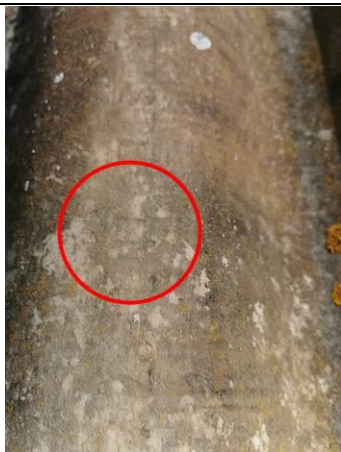
Photo n° PhA006 Localisation : Pool-house Ouvrage : Substrats et revêtements Partie d'ouvrage : Parties accessibles Description : Plafond - Bois et plaque fibrociment Localisation sur croquis : 003
