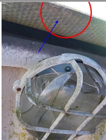
Photo n° PhA003 Localisation : Abris 2 Ouvrage : Plaques ondulées Partie d'ouvrage : Plaques en fibres-ciment Description : Plaques en fibres-ciment Localisation sur croquis : Point003
